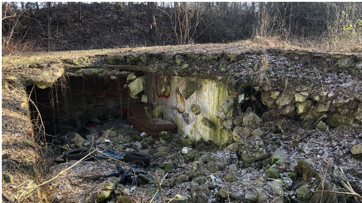
Fotografia 38 Zarwany budynek przy forcie
